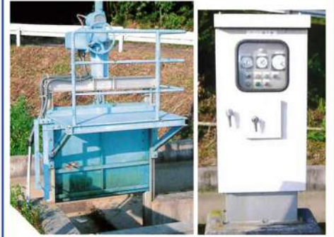
鋼製スルースゲート (電動式) 操作盤
