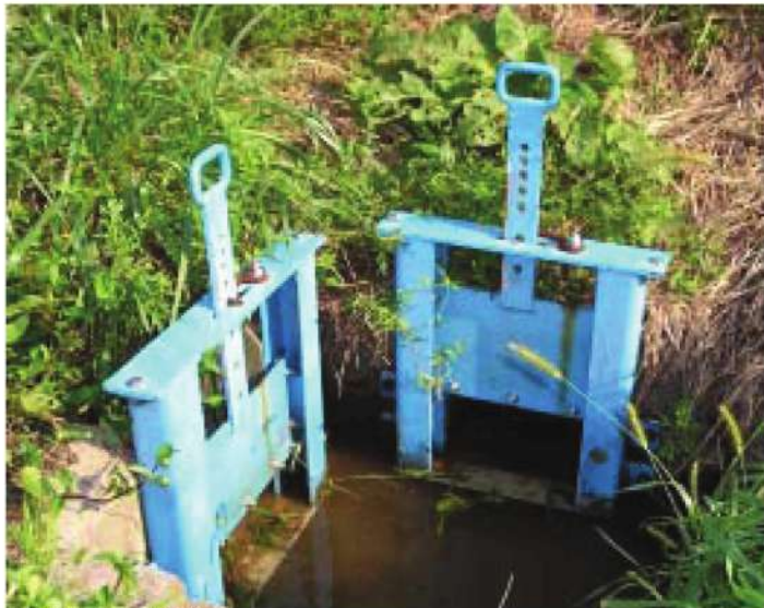
鋼製手上げゲート
