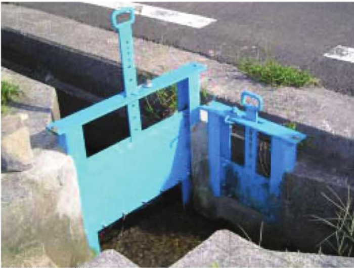
鋼製手上げゲート
